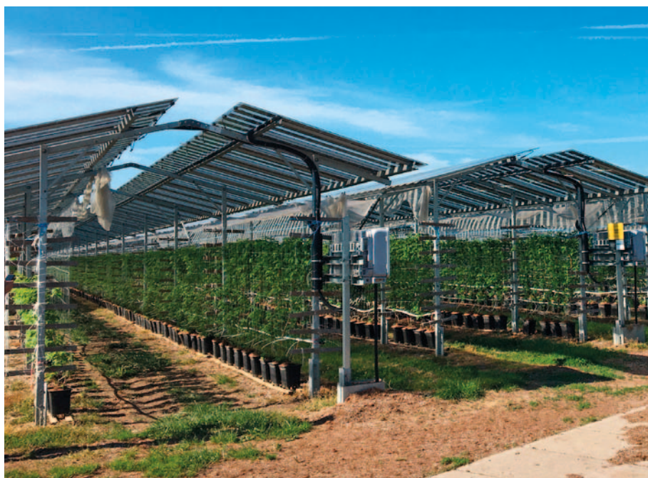
Foto 5. Agrovoltaická instalace u pěstitele malin (Foto: K. Scháňková)
